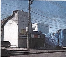
JR美唄駅の近くでは雪の重みで空き店舗が壊れ、前を走る国道12号が一時不通になった
